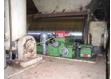
Wienerberger, DE-Zwickau Walzwerk: Rieter, 2012
